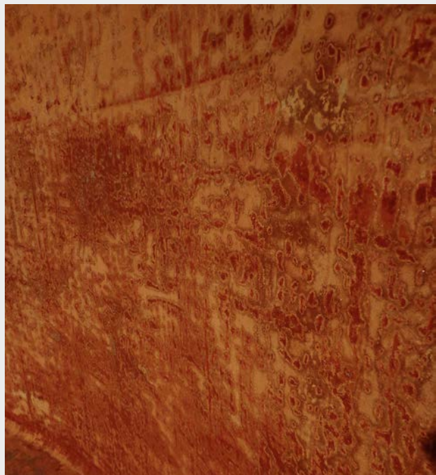
Fig. 3 Behälterwand mit weichen Flecken, Nord Franz. Legende
